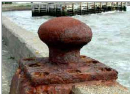
Slika 47. Primjer opće korozije [93]
