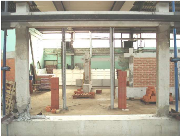
a) Oštećenje ispitnog uzorka O1
