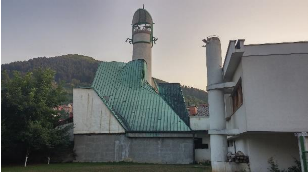
Kat. I. Sl. 7. Zelena limena oplata na krovu, (2016.).
